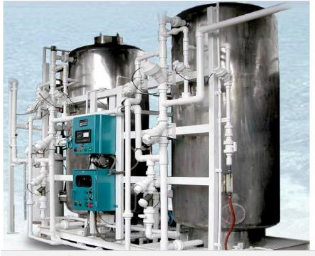
Ilustración 15 Equipos de desmineralización en acero inoxidable
