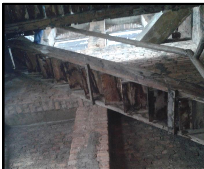
Imagen 41. Las escaleras y el entresuelo del campanario se encuentran en pobres condiciones físicas y es aquí donde se propondrá una reconstrucción del sistema para la conservación de la técnica en madera.
