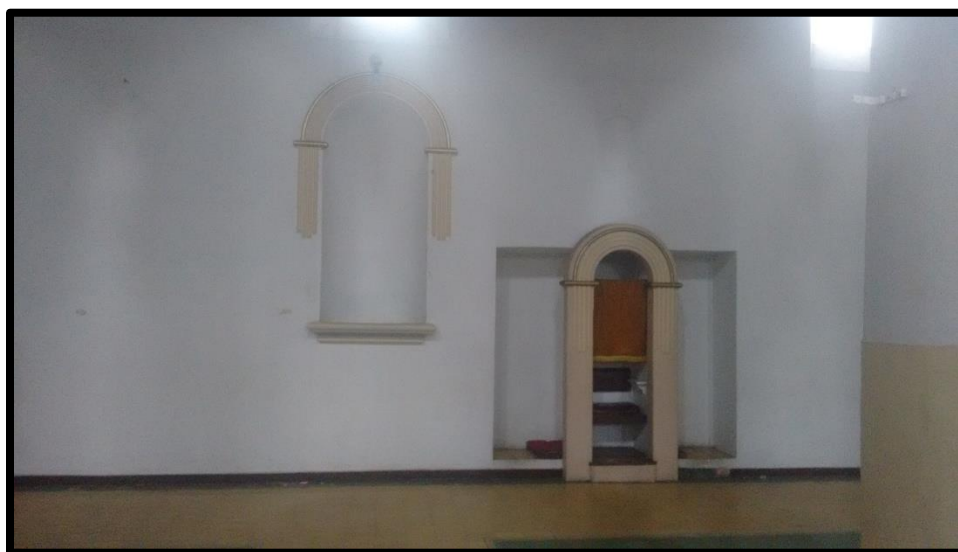
Imagen 32. Los nichos de las imágenes y los confesionarios serán intervenidos para asegurar y conservar la integridad estructural de los muros
