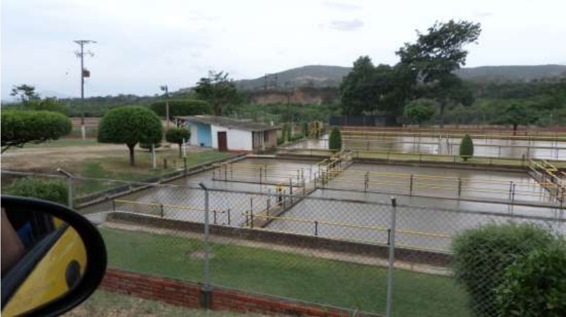
Planta De pretratamiento despues de la bocatoma El Portico
