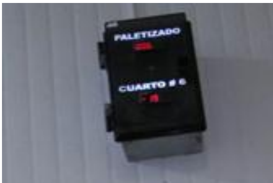
Imagen 11. Verificación de temperatura en cuarto de congelación
