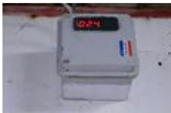
Imagen 12. Verificación de temperatura en cuarto de refrigeración
