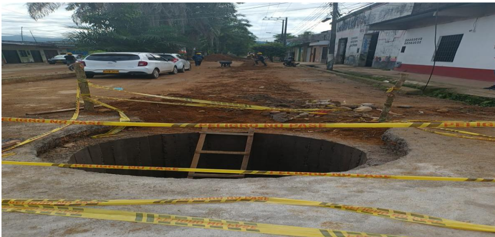
Ilustración 29. Señalización en pozo para evitar accidentes Fuente: Propia
