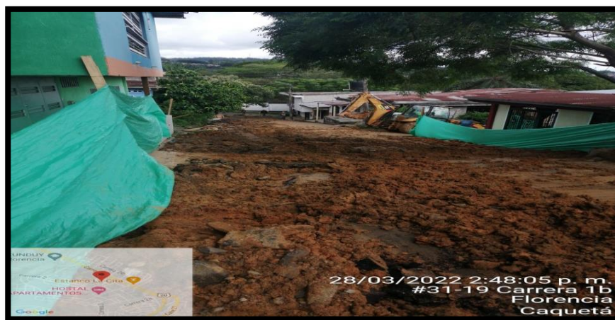
Ilustración 48. Material sobrante de la red principal no removido contrato 091 Fuente: Propia
