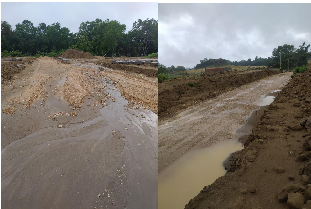
Figura 14. Efectos negativos de fuertes lluvias en obra.
