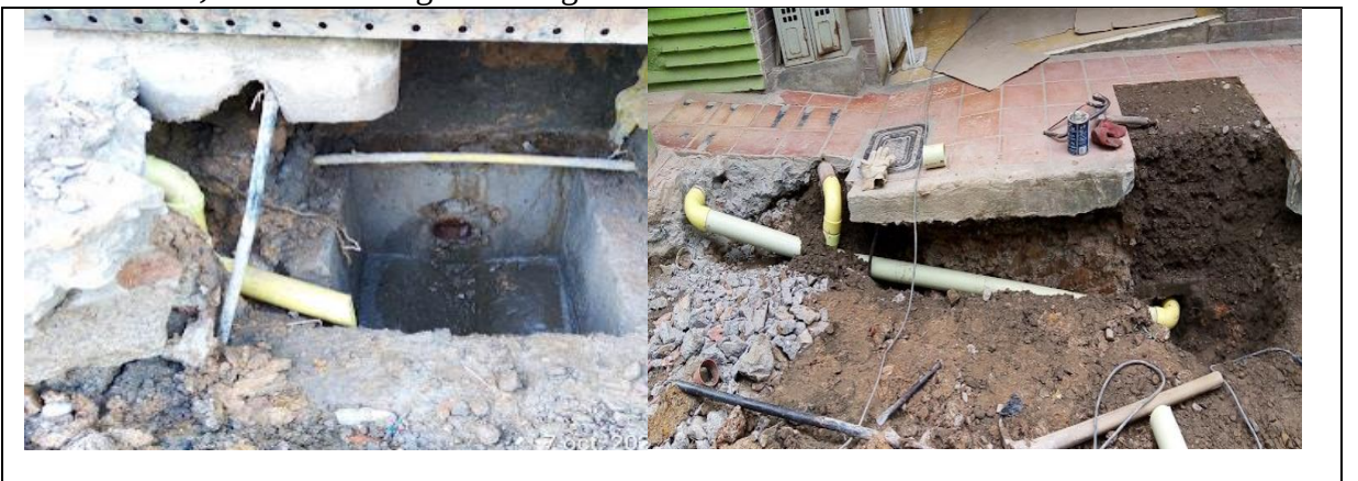
Ilustración 9, Cañuelas - Registro fotográfico
