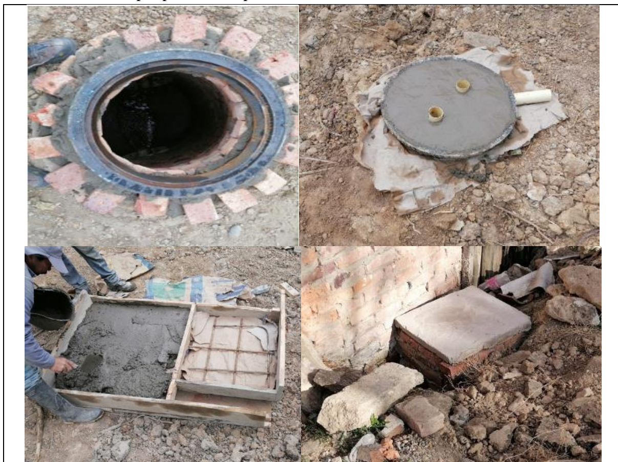
Ilustración 37, Tapas pozos de inspección
