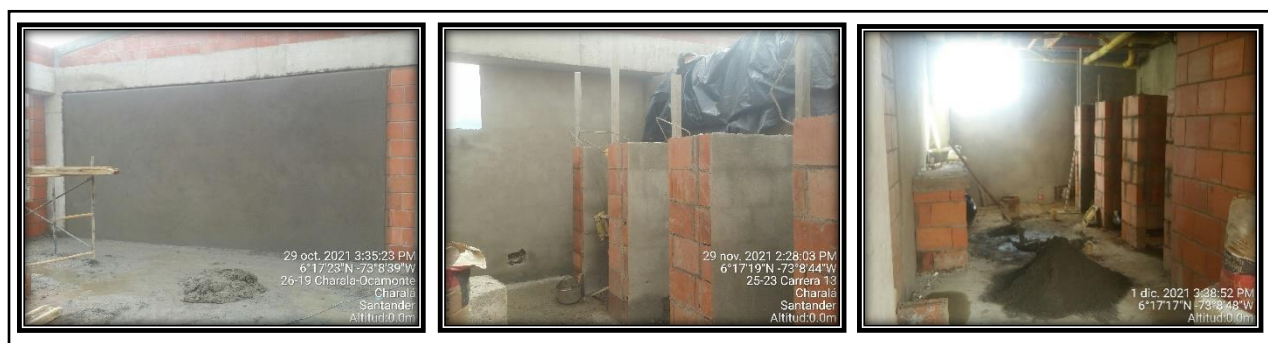
Figura 25, Pañetes en aulas y baterías sanitarias.
