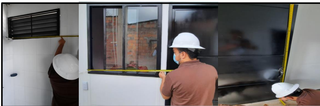
Ilustración 32. Carpintería metálica para vivienda
