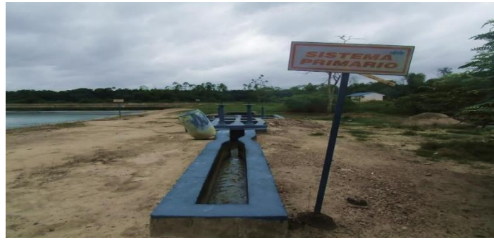
Figura 47. sistema de tratamiento primario PTAR
