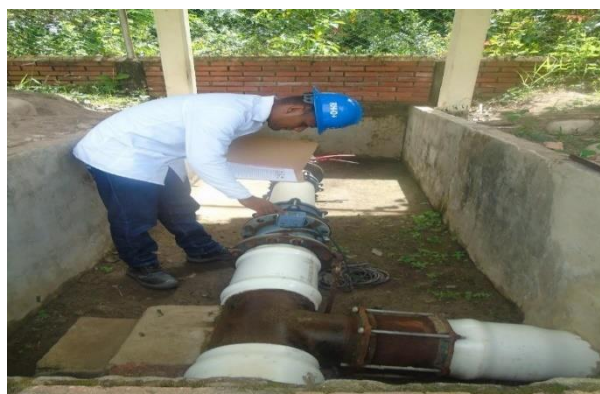
Figura 40. Registro de volúmenes de agua a la entrada de la PTAP
