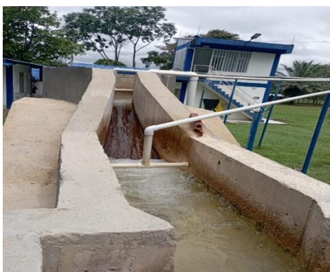
Figura 24. Canaleta Parshall de la PTAP
