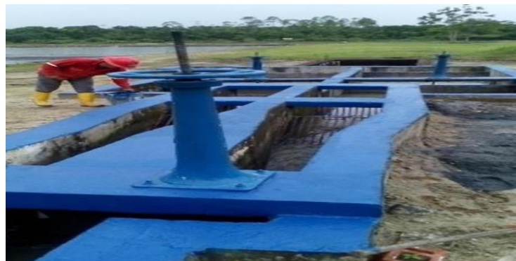
Figura 48. Trampa De Grasas-PTAR
