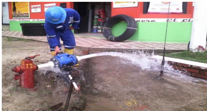
Figura 42. Aforo de hidrantes.
