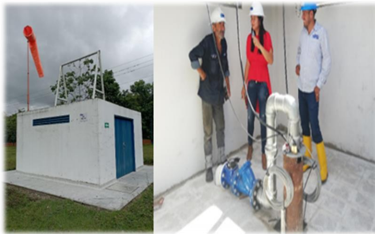
Figura 32. Pozo profundo como medida de contingencia
