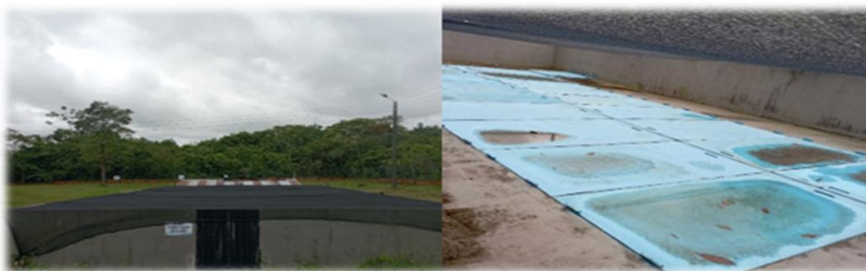
Figura 29. Tanque contactador de cloro
