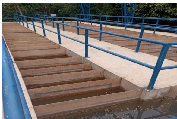
Figura 25. Floculador Hidráulico distribuidos en tres secciones
