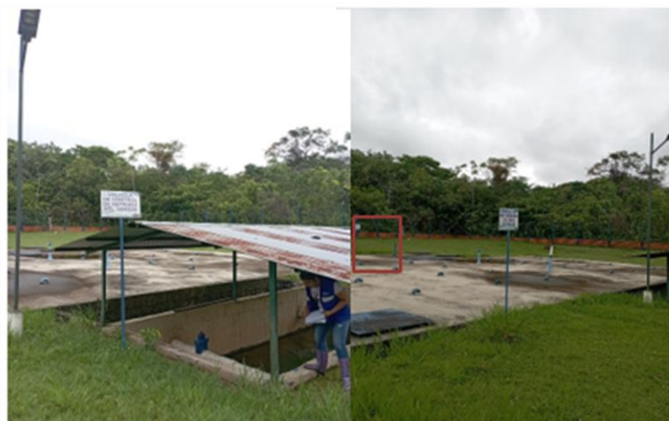
Figura 30. Ubicación de las válvulas de entrada y salida del tanque
