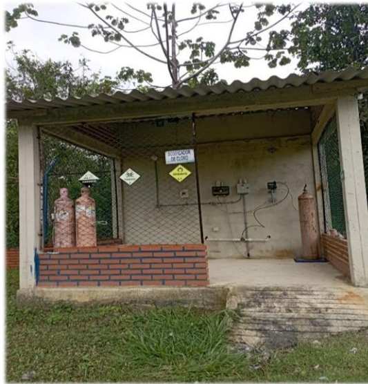
Figura 31. Caseta Dosificadora de cloro
