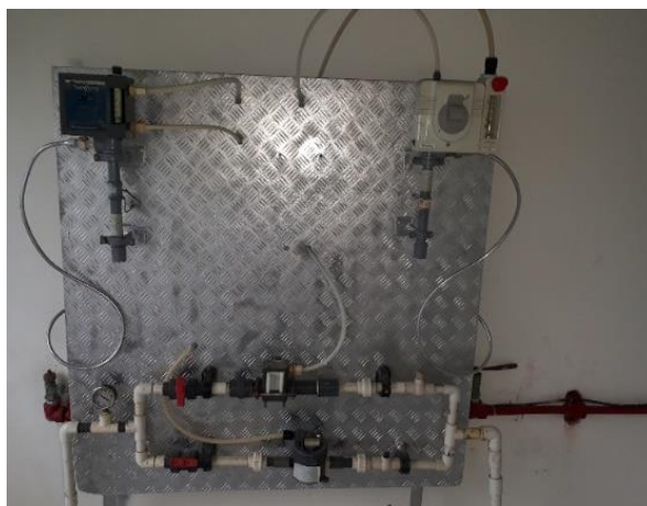
Figura 20. Dosificador de cloro gaseoso
