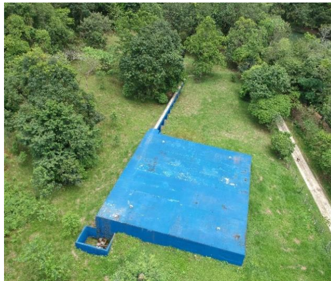
Figura 22. Tanque de almacenamiento.
