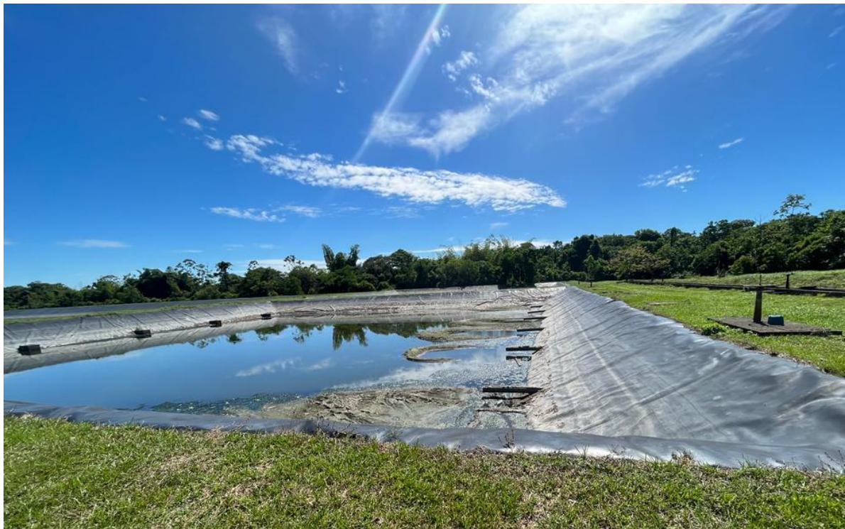
Figura 34. Lagunas anaerobias tren nuevo1 y 2
