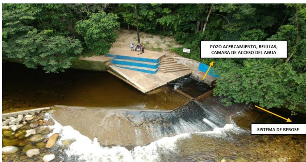
Figura 11. Rejillas, Cámara de acceso del agua y sistema de rebose.
