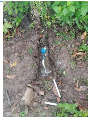
Ilustración 10. Válvulas de control instaladas
