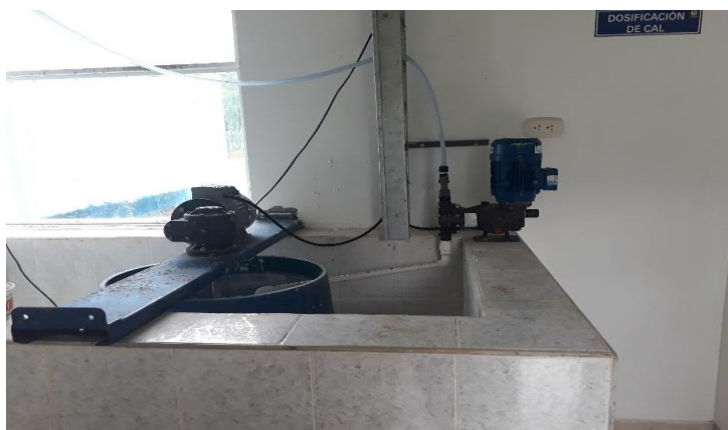
Figura 21. Dosificador de Cal
