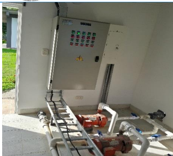
Ilustración 6. Cuarto de máquinas.
