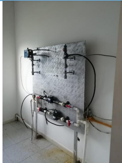
Ilustración 2. Dosificador de cloro gaseoso.
