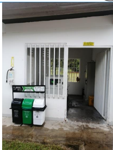
Cuarto planta eléctrica aislado
