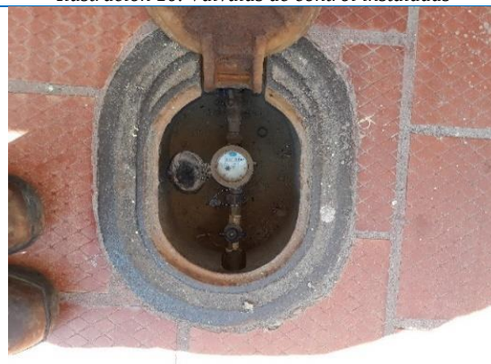
Ilustración 12. Micromedidor instalado marca AQUASOFT
