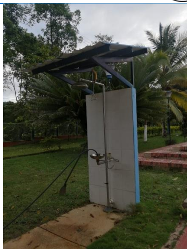
Ilustración 5. Duchas de emergencia.
