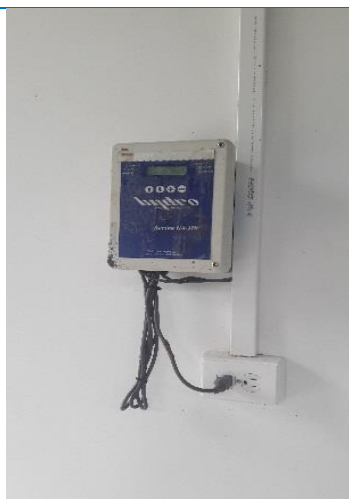
Ilustración 3. Detector de fugas de cloro.
