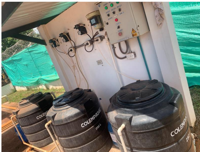
Imagen 15: Proceso de dosificación de insumos químicos y potabilización sistema “Nuevo horizonte”.
