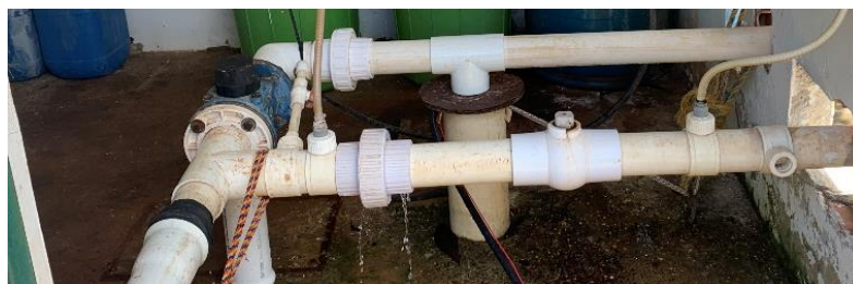
Imagen 1: Pozo Subterráneo Barrio Alcaraván.
