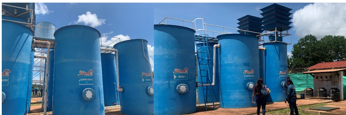
Imagen 16: Proceso de Floculación, Sedimentación y filtración sistema “Nuevo horizonte”.
