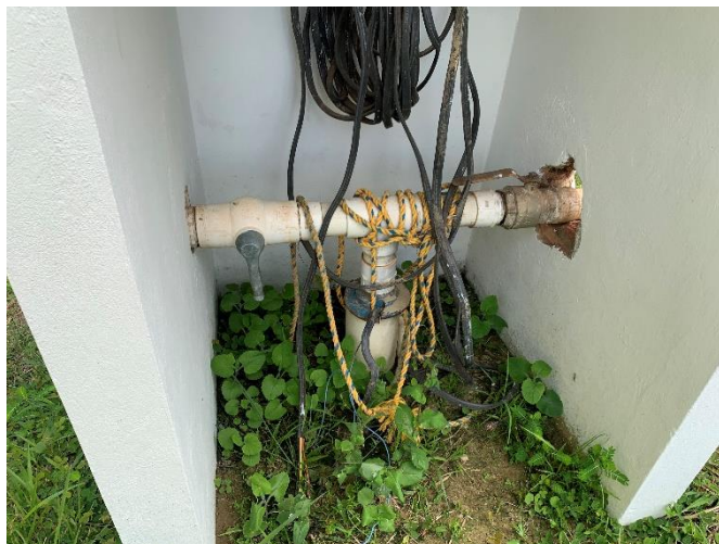
Imagen 2: Pozo Subterráneo Barrio Centro.
