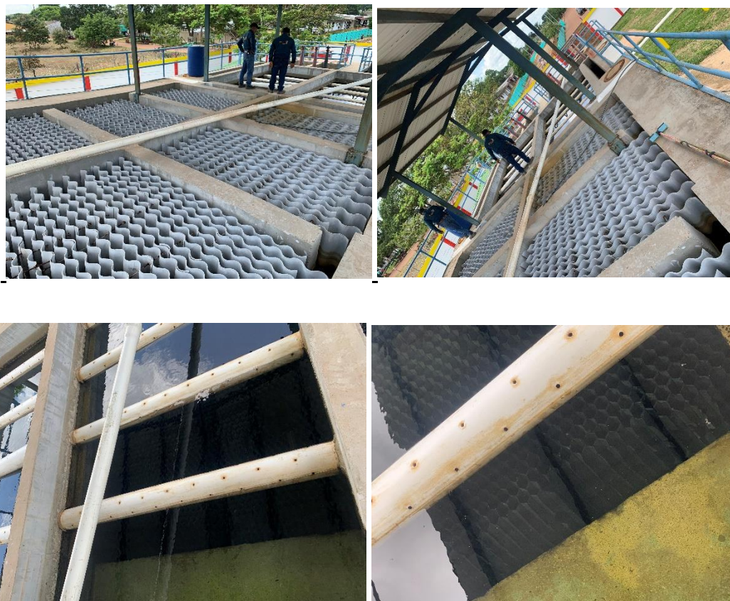
Imagen 11: Proceso de floculación y sedimentación sistema “Centro”.
