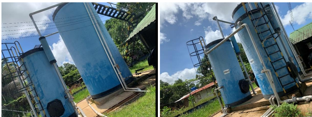
Imagen 6: tanques de Floculación y filtración del sistema “Alcaraván”.
