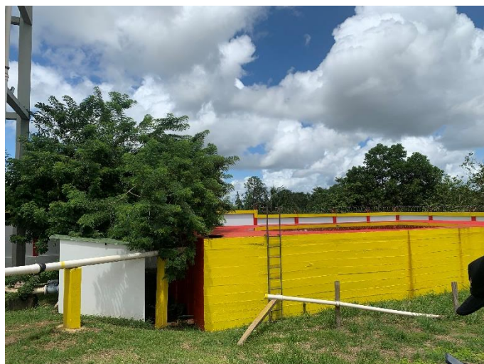
Imagen 12: Almacenamiento del agua sistema “Centro”.
