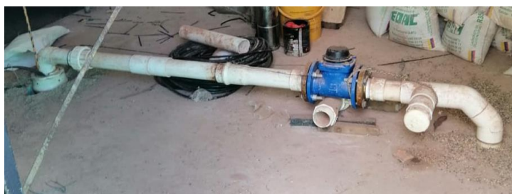
Imagen 3: Pozo Subterráneo Barrio Nuevo Horizonte.
