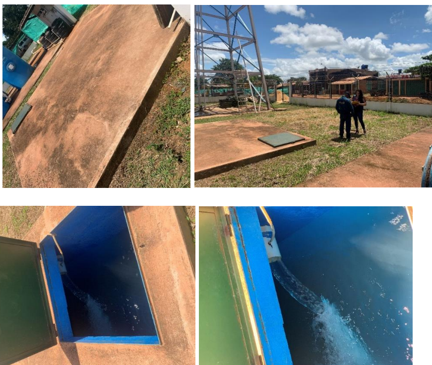
Imagen 17: Tanque de Almacenamiento subterráneo sistema “Nuevo Horizonte”.
