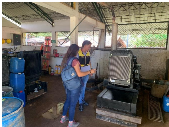
Imagen 8: Motobomba de distribución sistema "Alcaraván."
