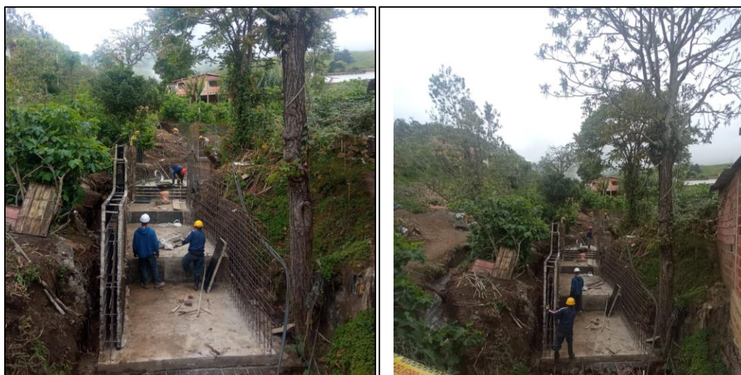
Ilustración 20. Canalización quebrada sector la chorrera
