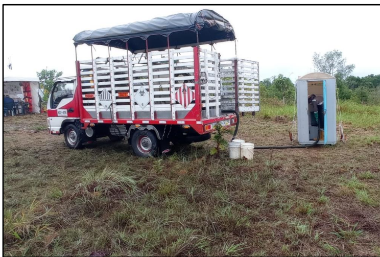
Ilustración 55 Suministro Y Mantenimiento De Unidad Sanitaria
