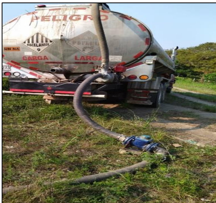
Ilustración 22 Caudalímetro instalado en el carro tanque
