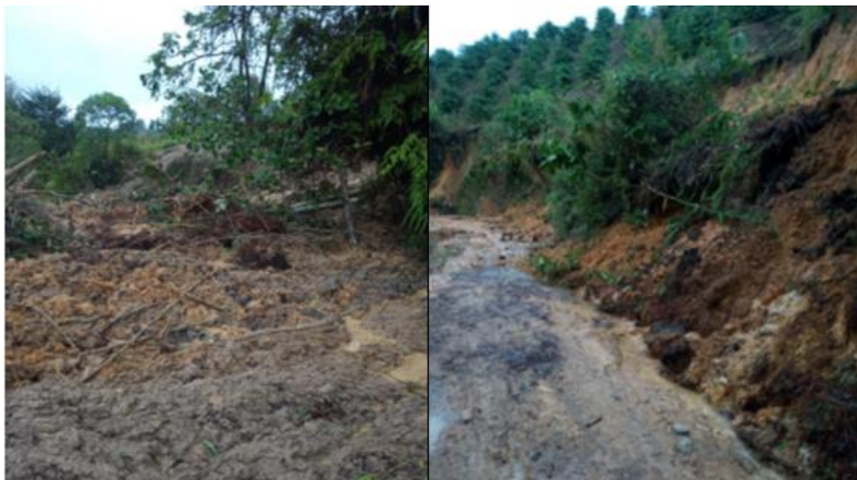
Ilustración 8 Remoción en masa afectación a Vía Autor: Oficina de Planeación Y desarrollo Económico
