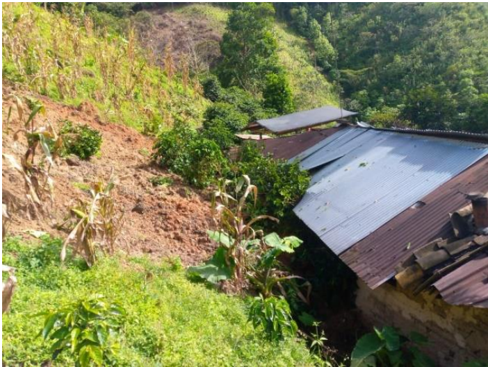
Ilustración 7 Remoción en masa afectación a vivienda Autor: Oficina de Planeación Y desarrollo Económico
