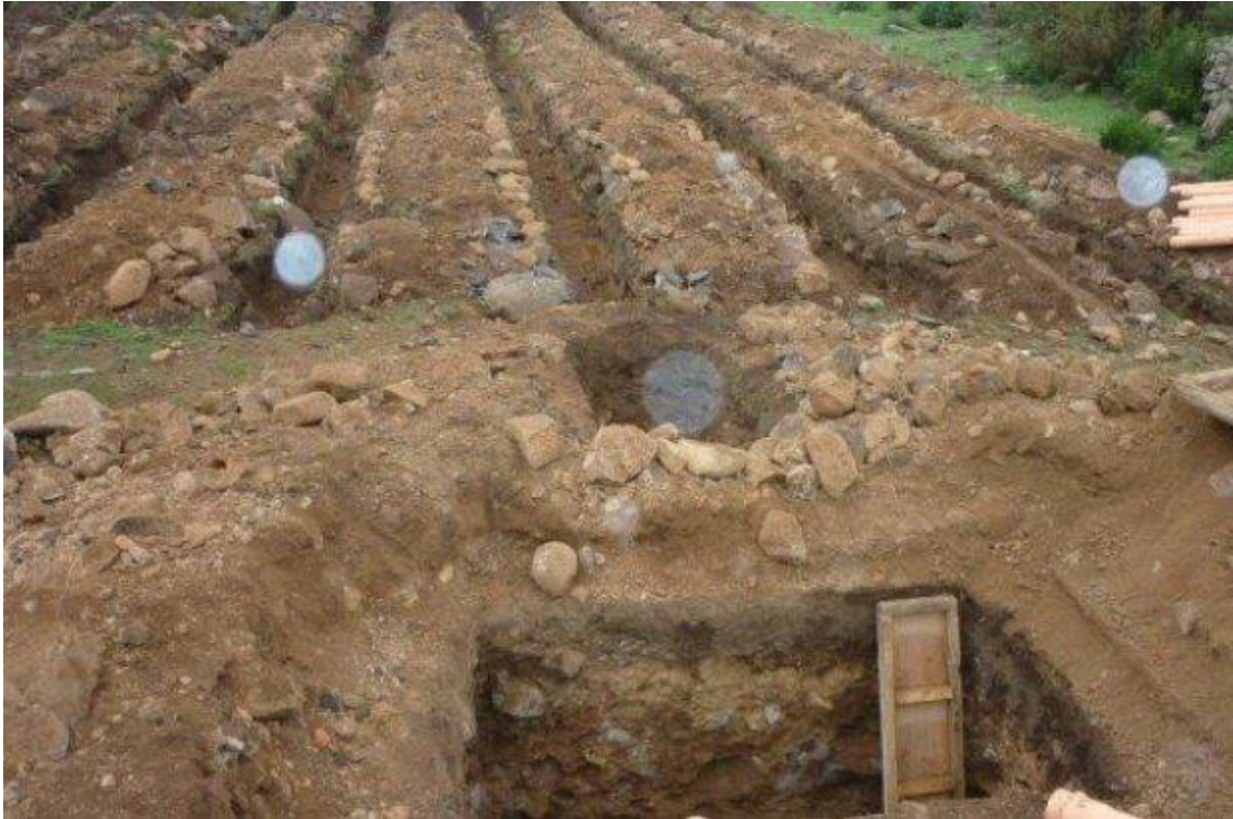
Figura 55. Adecuación de terrenos para la instalación de un sistema individual de tratamiento de aguas residuales, en el sitio de origen
