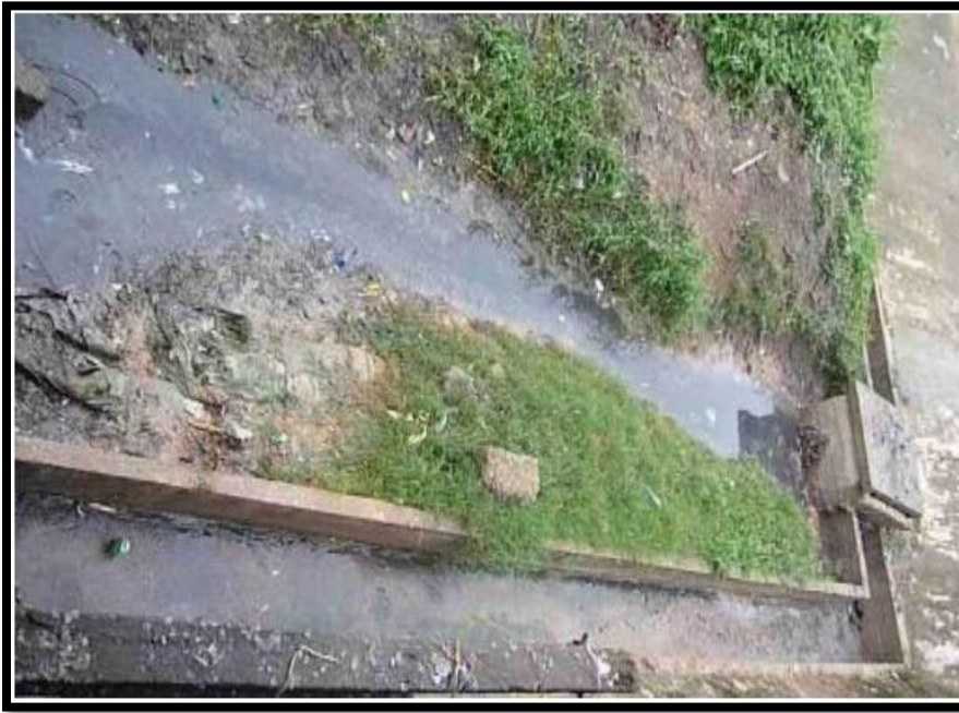
Figura 32. Sector Urbano de Leticia aguas lluvias no tratadas ni conducidas
