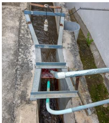
Figura 11. Punto de aplicación del coagulante.
