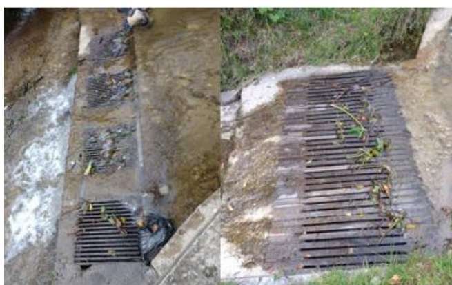
Figura 7. Estructura de captación Quebrada El Rosal y Cariongo.
