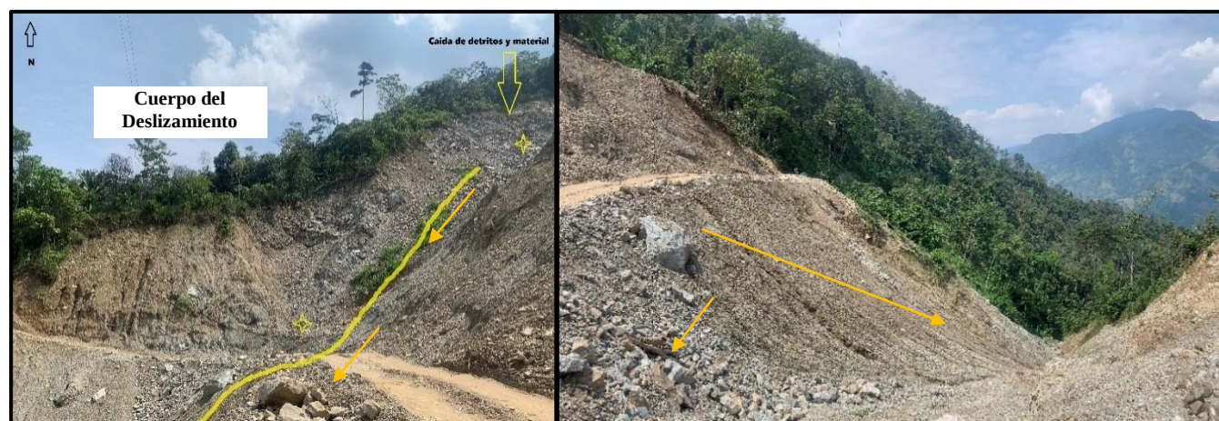
Figura 4. Deslizamiento de detritos en la vía que comunica Durania con Villa sucre
