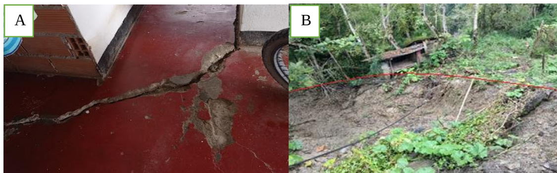
Figura 9 Afectaciones estructurales a viviendas Insp. San Francisco, municipio El Calvario.
