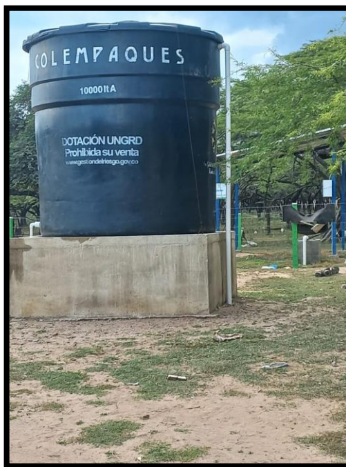
Ilustración 18. sistema de Abastecimiento de agua Potable
