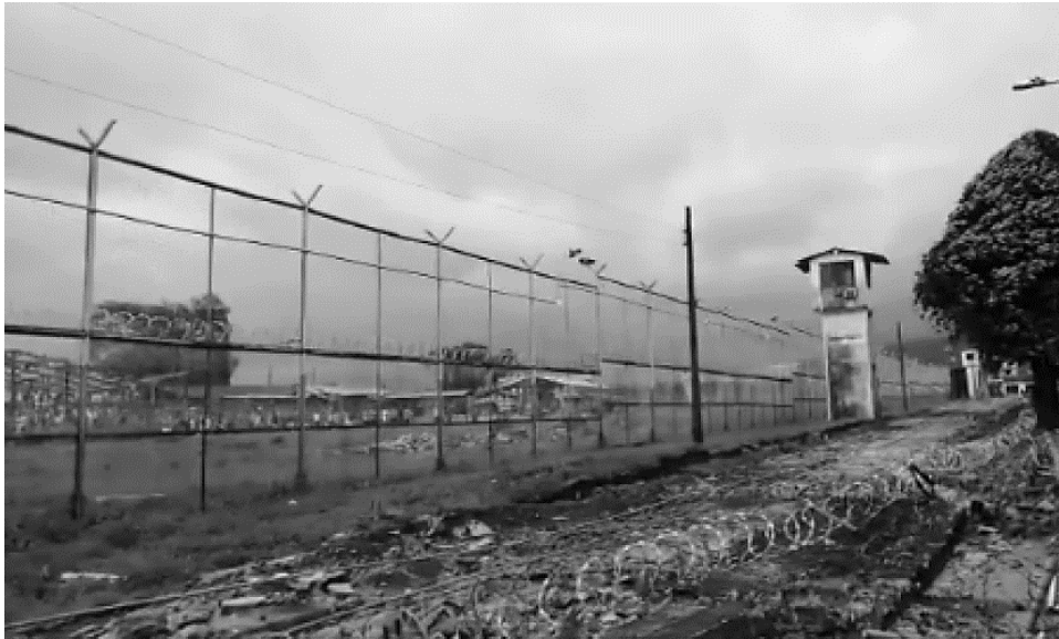
Ilustración 84. Escombros del colapso del muro.
