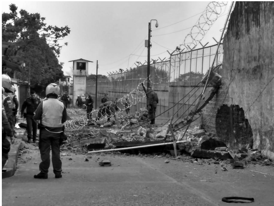
Ilustración 83. Desplome del muro exterior del centro penitenciario.
