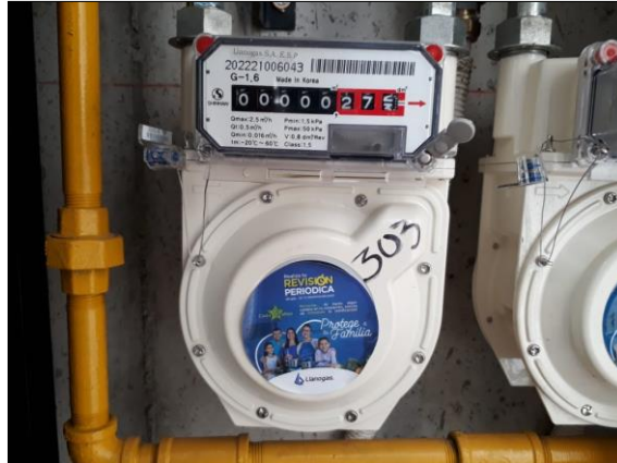
Medidor de Gas.
