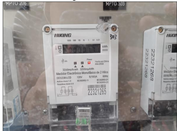
Medidor de energía.
