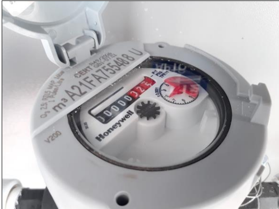
Medidor de Agua.
