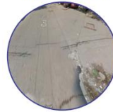
Deterioro de la vía
