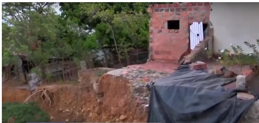
Ilustración 24 imagen colapso de vivienda
