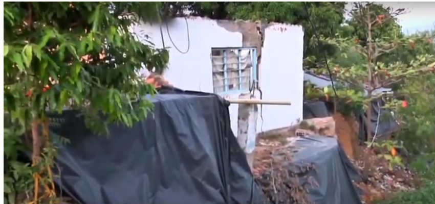
Ilustración 23 imagen colapso de vivienda
