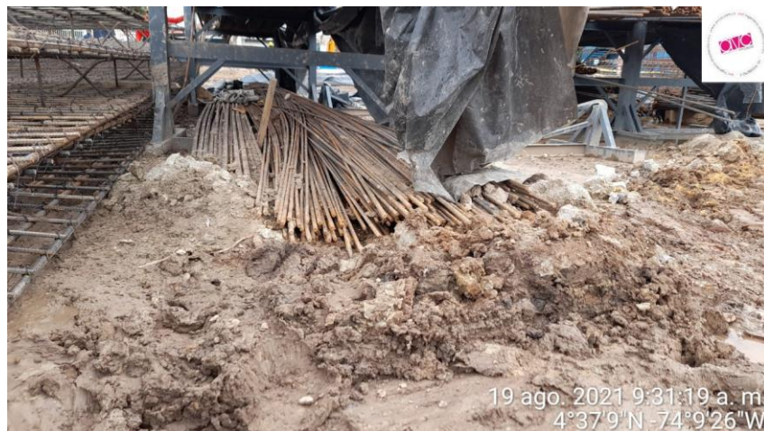
Figure 24 Acero expuesto al terreno Fuente: Propia
