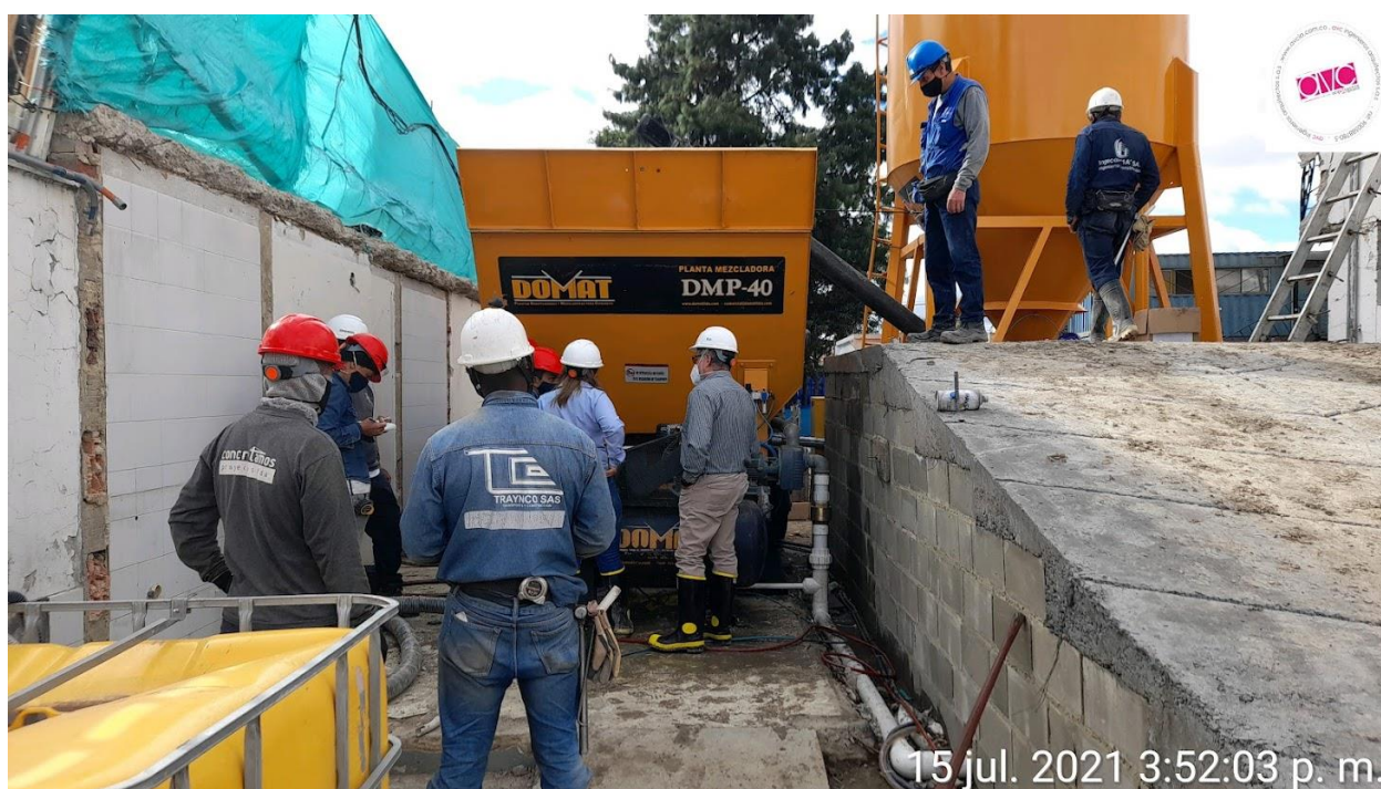
Figure 63 Planta de concreto DOMAT DMP-40. Fuente: Propia.
