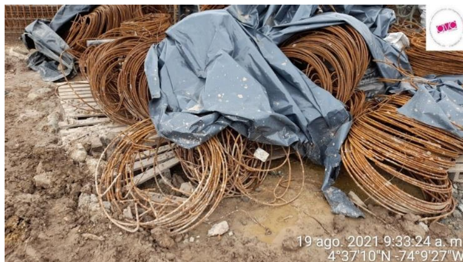
Figure 25 Acero con presencia de óxido. Fuente: Propia.
