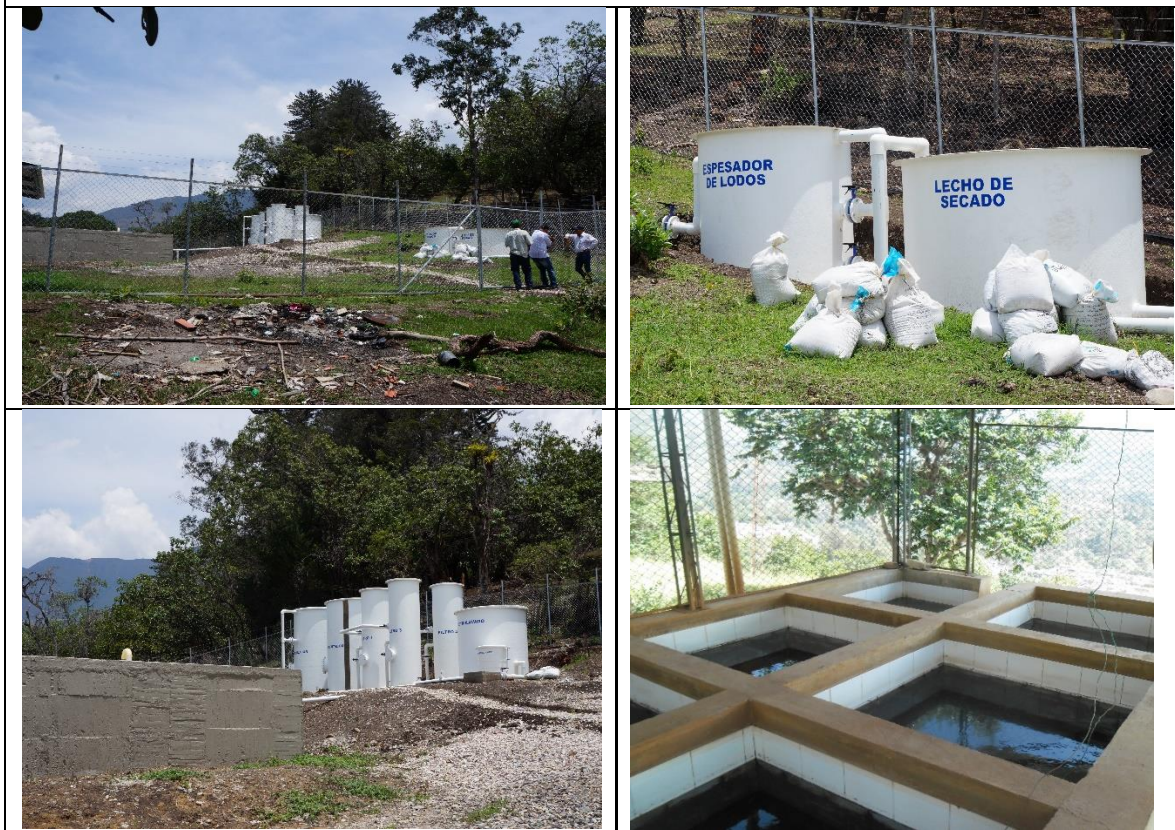
Figura 9. Planta de tratamiento
