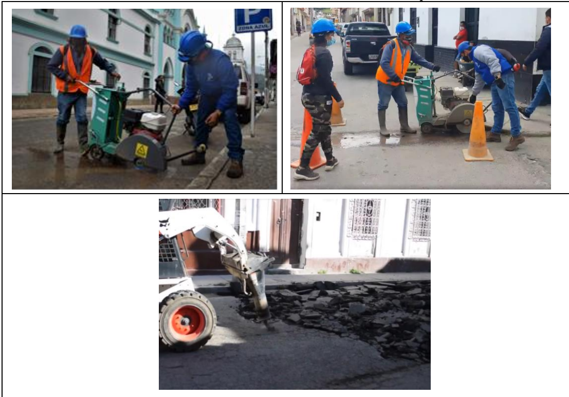
Evidencia de obras de bacheo realizadas en el municipio
