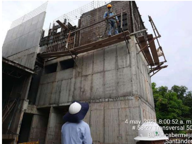
Ilustración 19. Recordatorio a obrero sobre la importancia de la seguridad del arnés. Fuente: Propia
